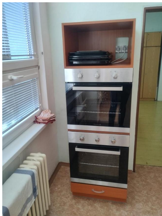
Nově instalované trouby v cvičné kuchyni.
